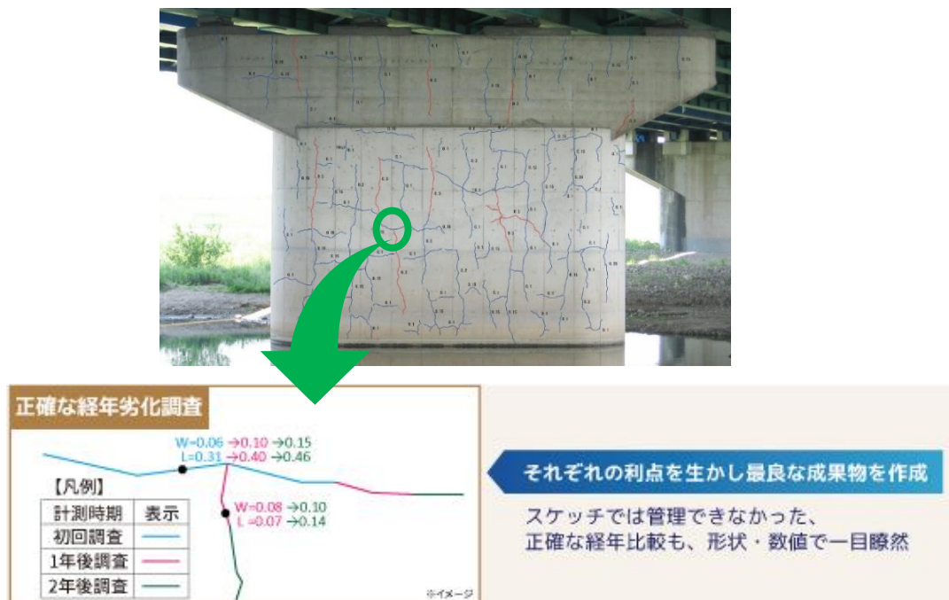
図 2.4-1. ひび割れのデジタル化と高精度な記録の例
