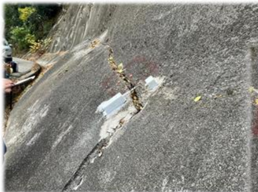
⑨法面モルタル吹付工のひび割れ 関西情報センター（大阪府池田土木事務所）
